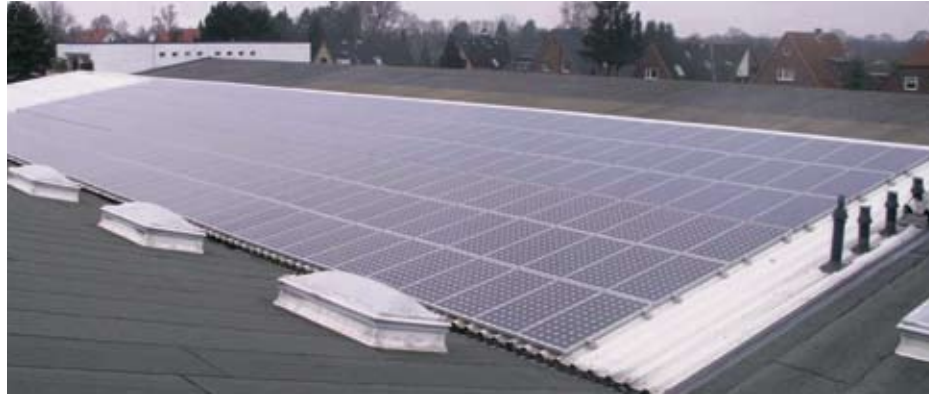
Photovoltaikanlage von Preuss Messe mit einer Gesamtfläche von 500 Quadratmeter für Nachhaltigkeit und sauberen Strom
